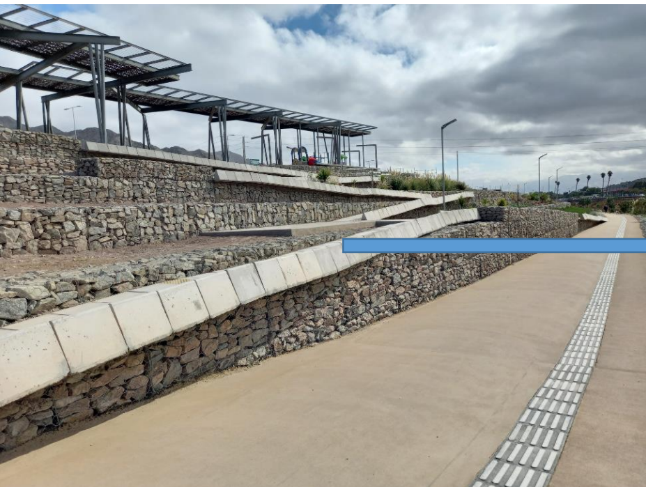
Rampas sin barandas
