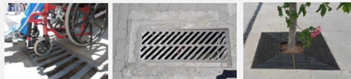
Foto 16 (izq): Rejillas puestas peligrosamente a favor de la circulación peatonal pudiendo causar atascos de las ruedas. Foto 17 (centro): El diseño de rejilla permite su instalación en cualquier sentido impidiendo el atasco de ruedas de una silla o coche. Foto 18 (der): Protección de taza de árbol correctamente enrasada y de color contrastante.
